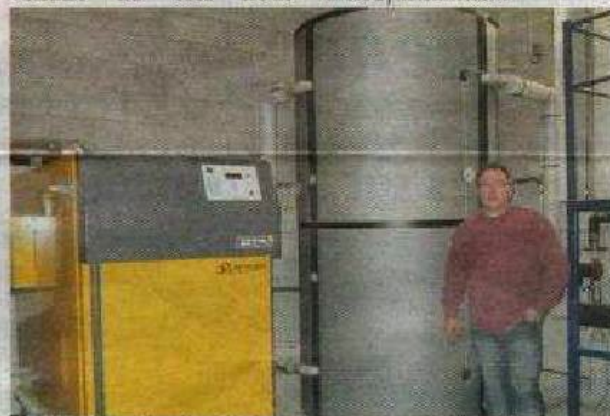
William dans la chaufferie, en contrebas de l'atelier, avec la chaudière et son ballon tampon de 3000 l.
